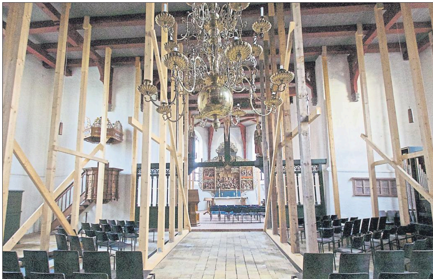
Das Betreten der Kotzenbüller Kirche Sankt Nikolai ist nur dank einer provisorischen Stützbalkenkonstruktion sicher möglich.
